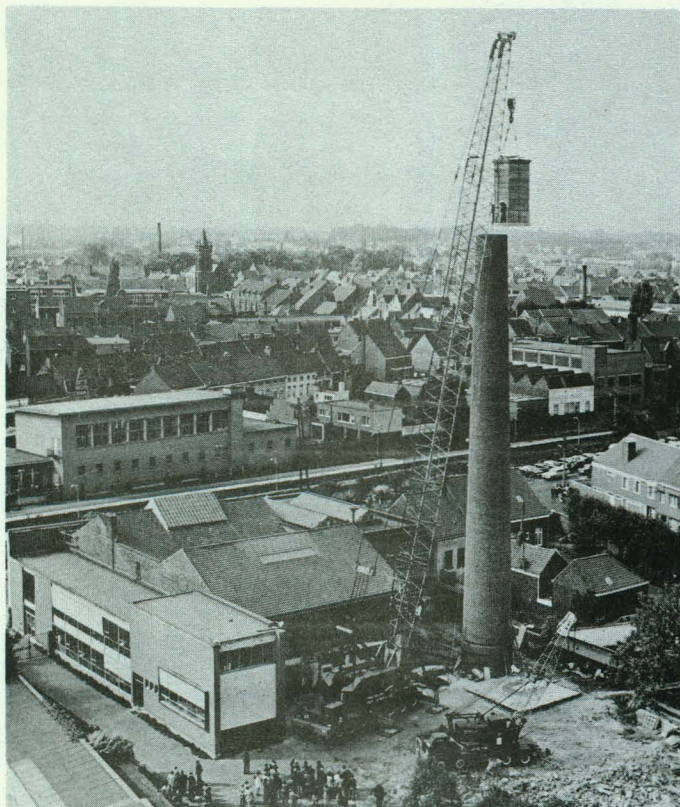
5.9 — De 18 ton zware kabine wordt op de schoorsteen geplaatst van de elektriciteitscentrale.
